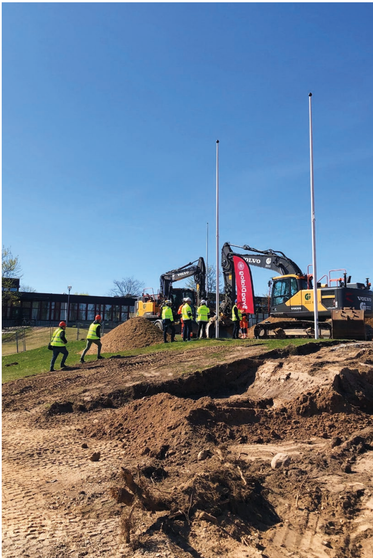
I början av maj var det dags för första spadtaget för nya Park Arena.
