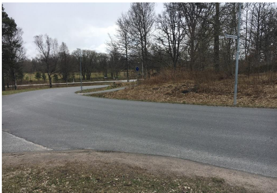
Bilden visar växtligheten som skymmer cykelvägen söder om Fräkenvägen. 2017.
